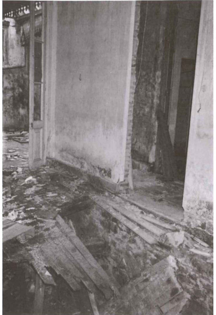
Fig. 34 - Foto ilustrativa del estado del edificio de la ex telefónica cuando fue cedido por ANTEL a la Intendencia mediante comodato para la instalación del museo. Esto no se pudo concretar. Posteriormente fue reciclado y en él funciona la Sala Cultural de ANTEL.
